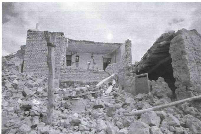
Последствия землетрясения в Иране 5 апреля 2017 г.
